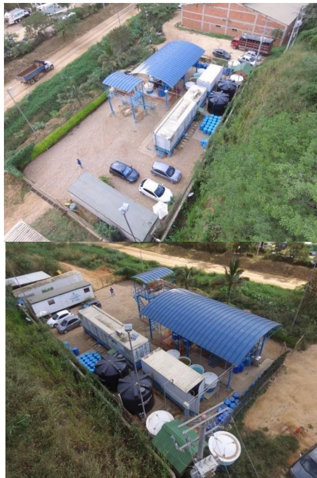
Figura 10. Registro fotográfico de la PTLX del Carrasco.
